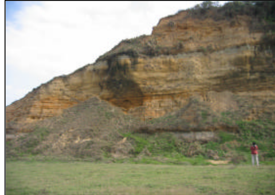
照片 3-4 大南灣層的崩塌地 地點：出水坑溪出海口, 2004/11 攝
