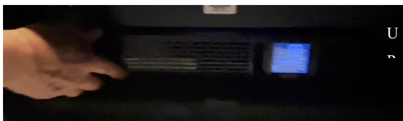
圖 50 不斷電系統 UPS（2023 研究者自攝）
