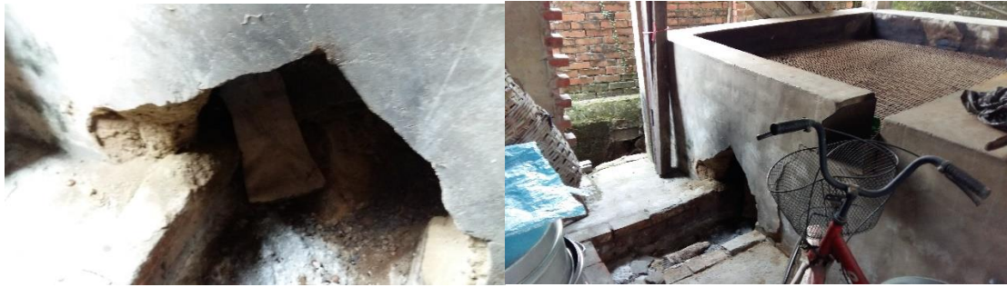
圖 2-15：龍眼乾烘爐火口(左)與龍眼乾烘爐(右)
